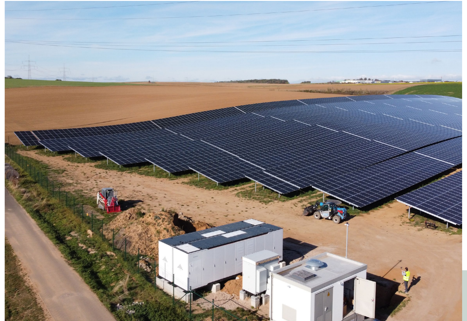
Solar und Speicher in Theilheim, Germany: Eine Freiflächenanlage mit einem SC3125HV-30 Wechselrichter und zwei Sungrow PowerTitan ST2752UX Speichersystemen
